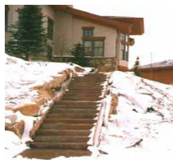
przykład wykonanej i funkcjonującej instalacji pod nawierzchnią schodów, spocznikami, tarasem
